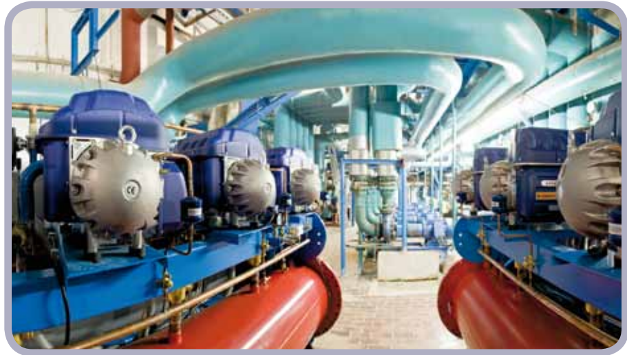
Abbildung 11: Zwei QUANTUM-Kältemaschinen kühlen den WDR in Köln.
